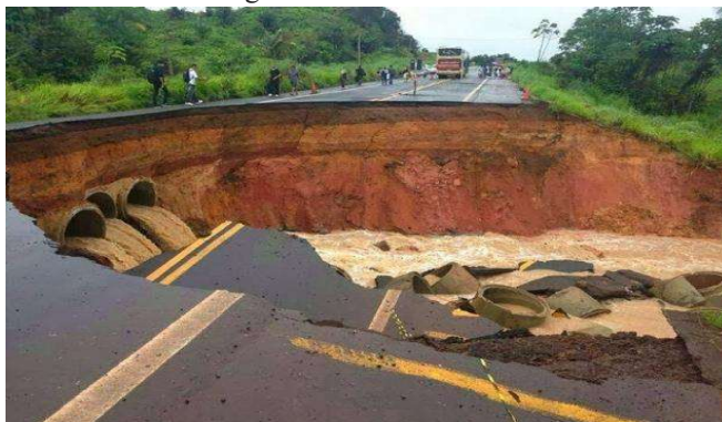
Figura 1: Erosão do solo
