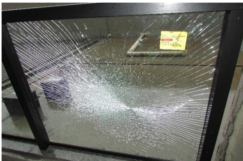
Figura 17: Elemento de fechamento após impacto.
