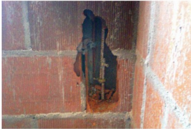
Figura 6 - Aplicação incompleta do concreto no graute, resultando em vazios que comprometem a aderência e a resistência (Fonte: SOUZA, 2011).
