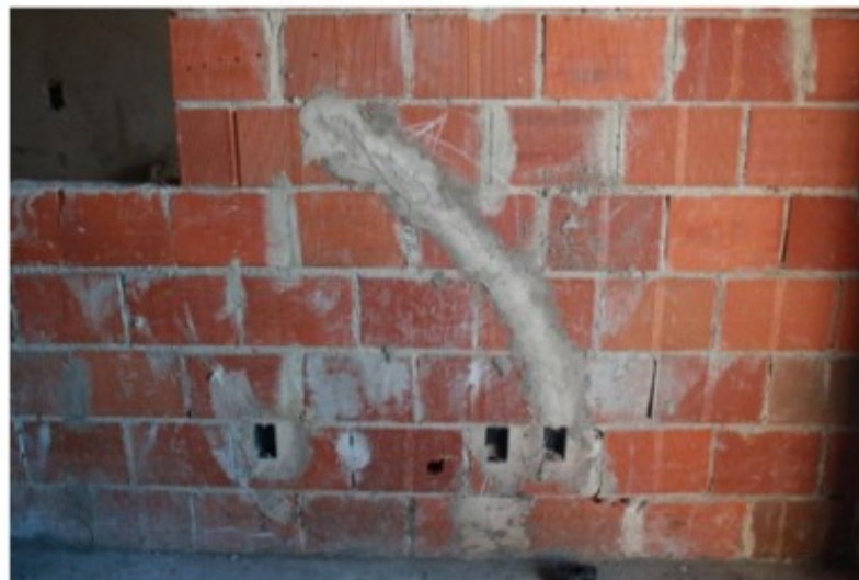
Figura 7 - Cortes inadequados na alvenaria estrutural, comprometendo a integridade e resistência da parede. (Fonte: SOUZA, 2011).
