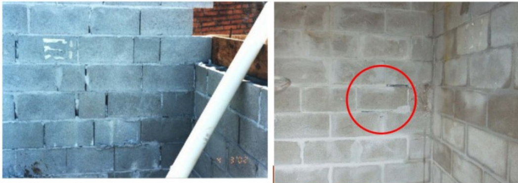
Figura 8 - Preenchimento de juntas de forma inadequada (Fonte: POZZOBON, 2003).
