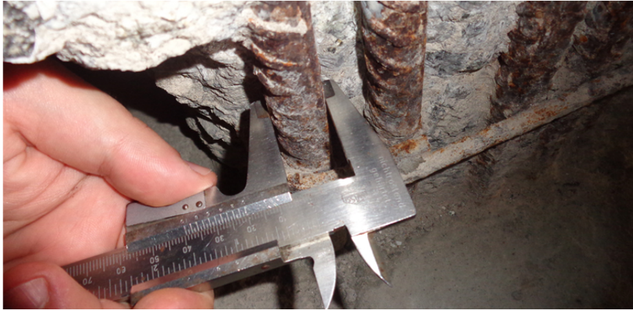
Figura 10 - Corrosão de Pilar devido a umidade. (Fonte: Próprio Autor).
