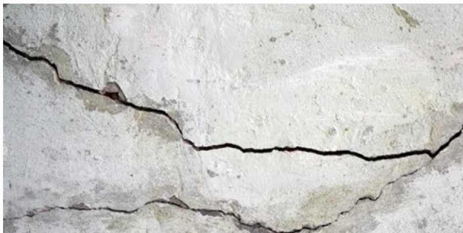
Figura 9 - Fissuras e trincas por falha na execução em concreto armado (Fonte: Próprio Autor).
