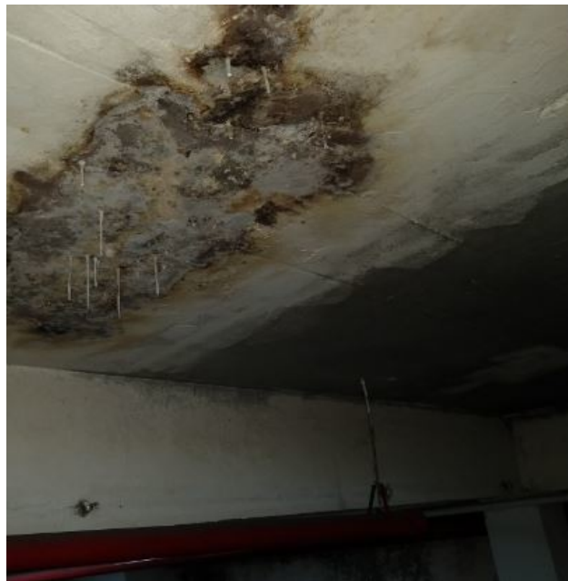
Figura 11 - Infiltração devido à falta de impermeabilização (Fonte: Próprio Autor).
