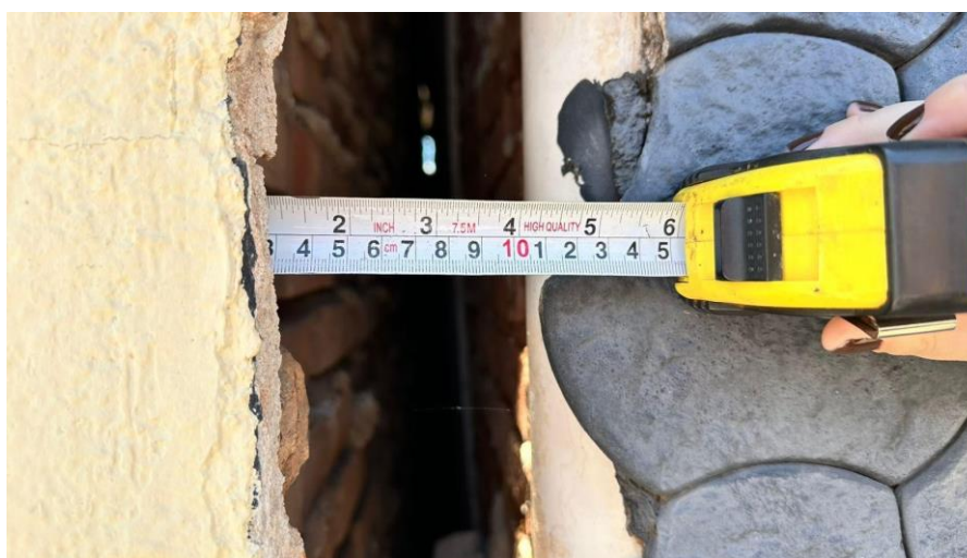
Figura 8 – Foto do distanciamento das paredes, 2024 (Fonte: Próprio autor).
