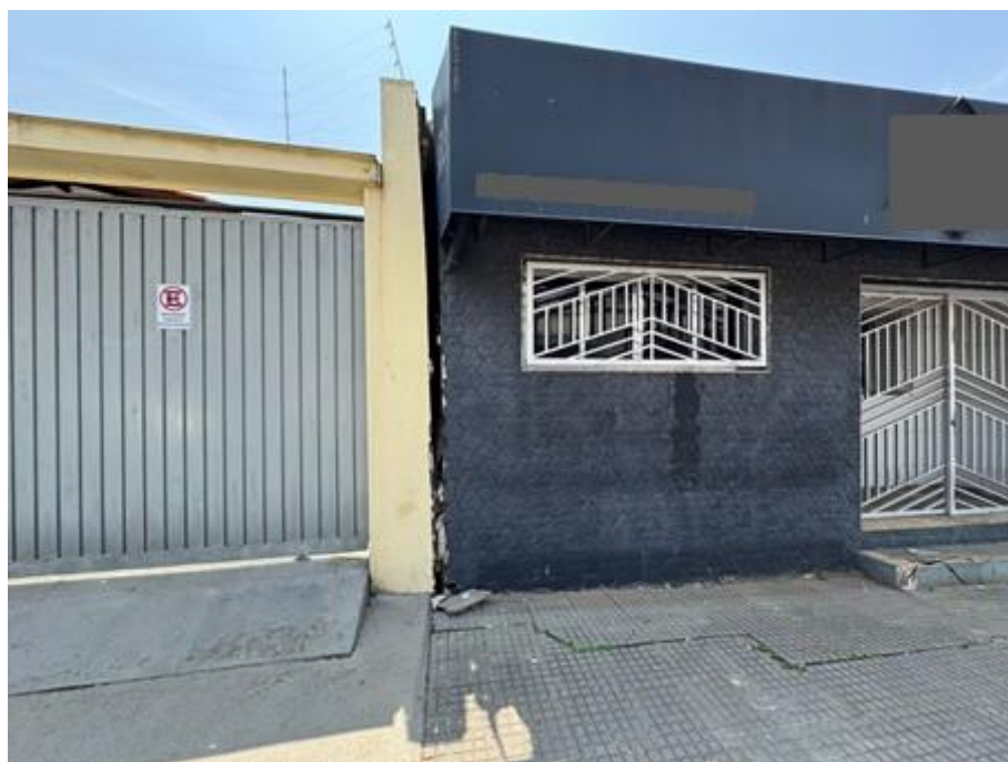
Figura 6 – Foto mais recente da fachada do empreendimento que foi afetado, em 2024 (Fonte: Próprio autor).
