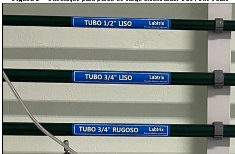
Figura 3 – Tubulação para perda de carga distribuída, USF, São Paulo
