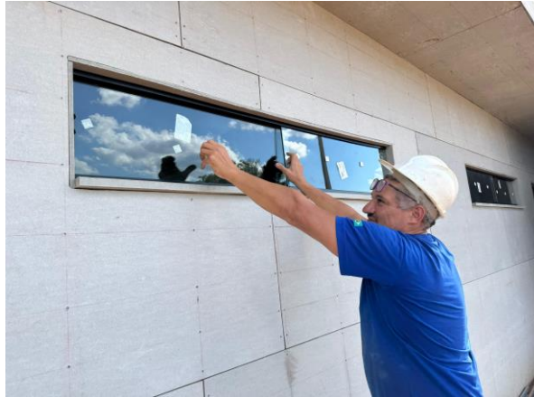
Figura 7 – Instalação de esquadria na estrutura executada em Steel Frame (Fonte: Próprio autor).
