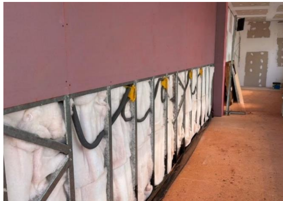
Figura 14 – Placas de drywall RF instaladas no LSF (Fonte: Próprio autor).
