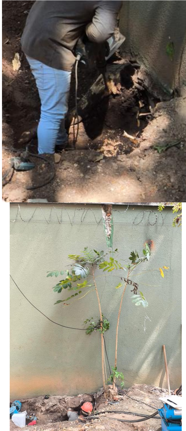
Figura 9 – Raiz de árvore alojada sob o baldrame (Fonte: Dos autores, 2024).
