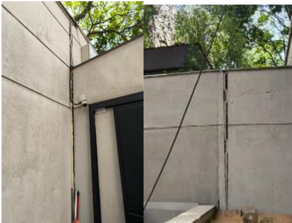
Figura 8 – Trincas, fissuras, desaprumos e distorção angular devido ao recalque diferencial (Fonte: Dos autores, 2024).
