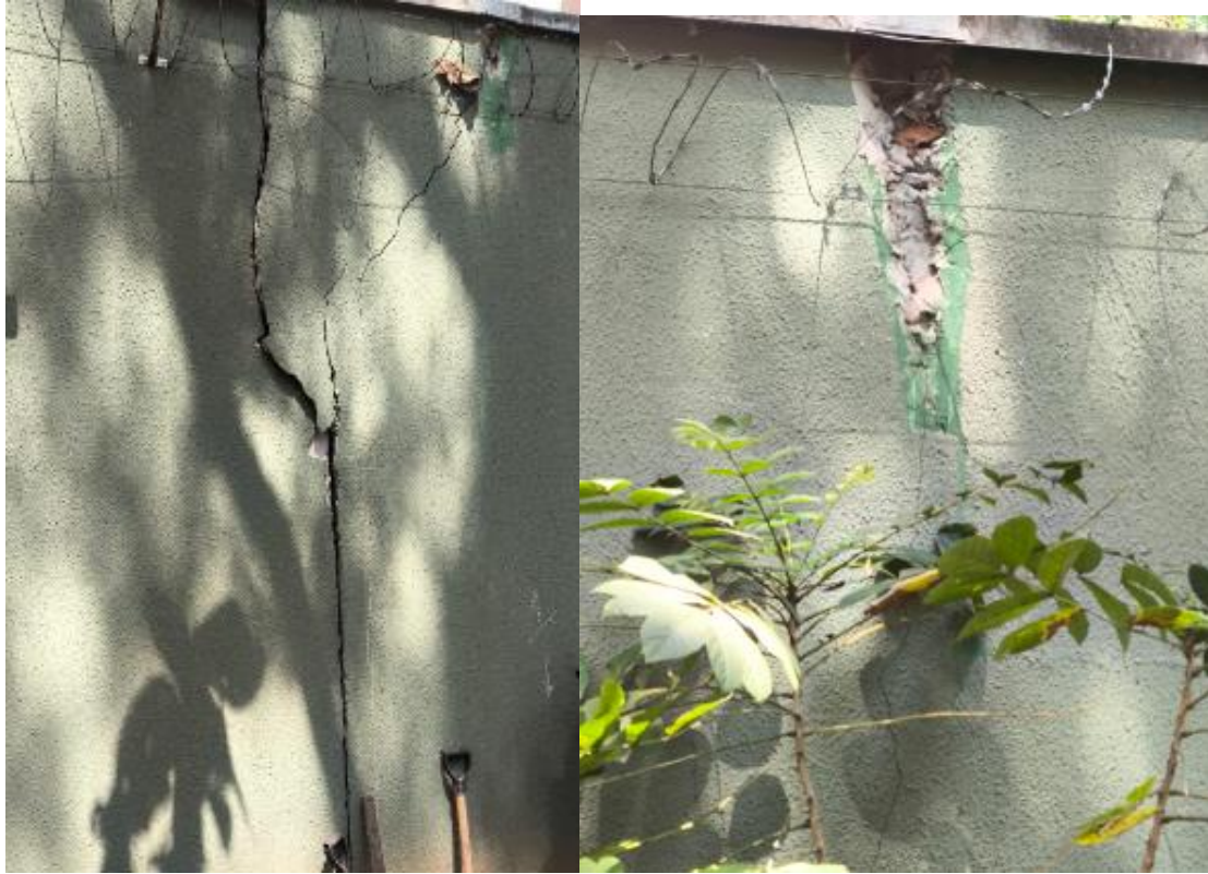
Figura 7 – Trincas, fissuras e desaprumos devido ao recalque diferencial (Fonte: Dos autores, 2024).
