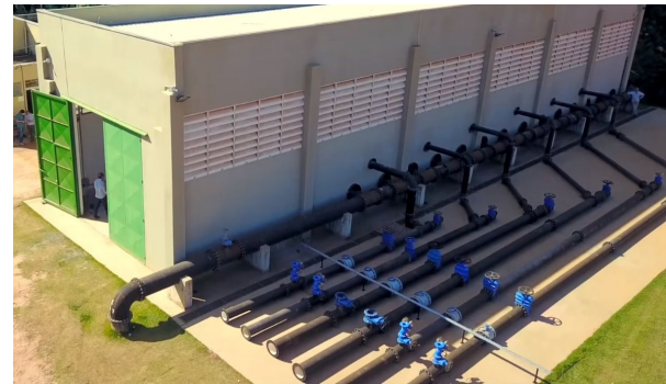
Figura 3.0 - Estação elevatória da cidade de Louveira 10 de Julho de 2020 [12]
