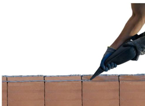
Figura 5 – Foto do aplicador de nylon usando argamassa pronta para assentamento em blocos cerâmicos.
