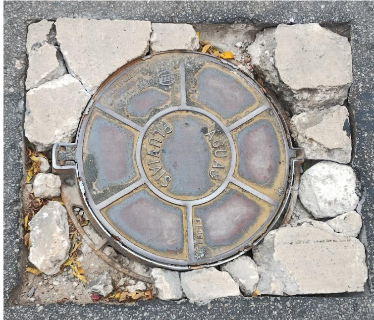
Figura 9 - Laje danificada, 27/10/2023 - Av. Amoreiras com R. Dr. Cassiano Gonzaga (Fonte: O autor)
