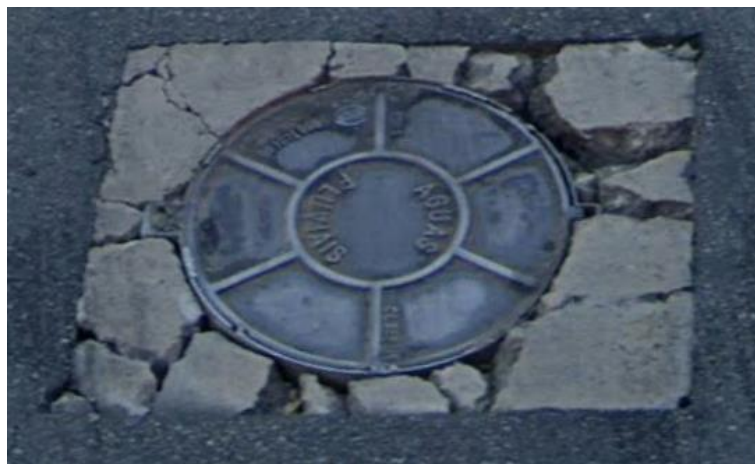
Figura 10 - Laje danificada, 07/2023 - Av. Amoreiras com R. Dr. Cassiano Gonzaga (Fonte: Google Street View)
