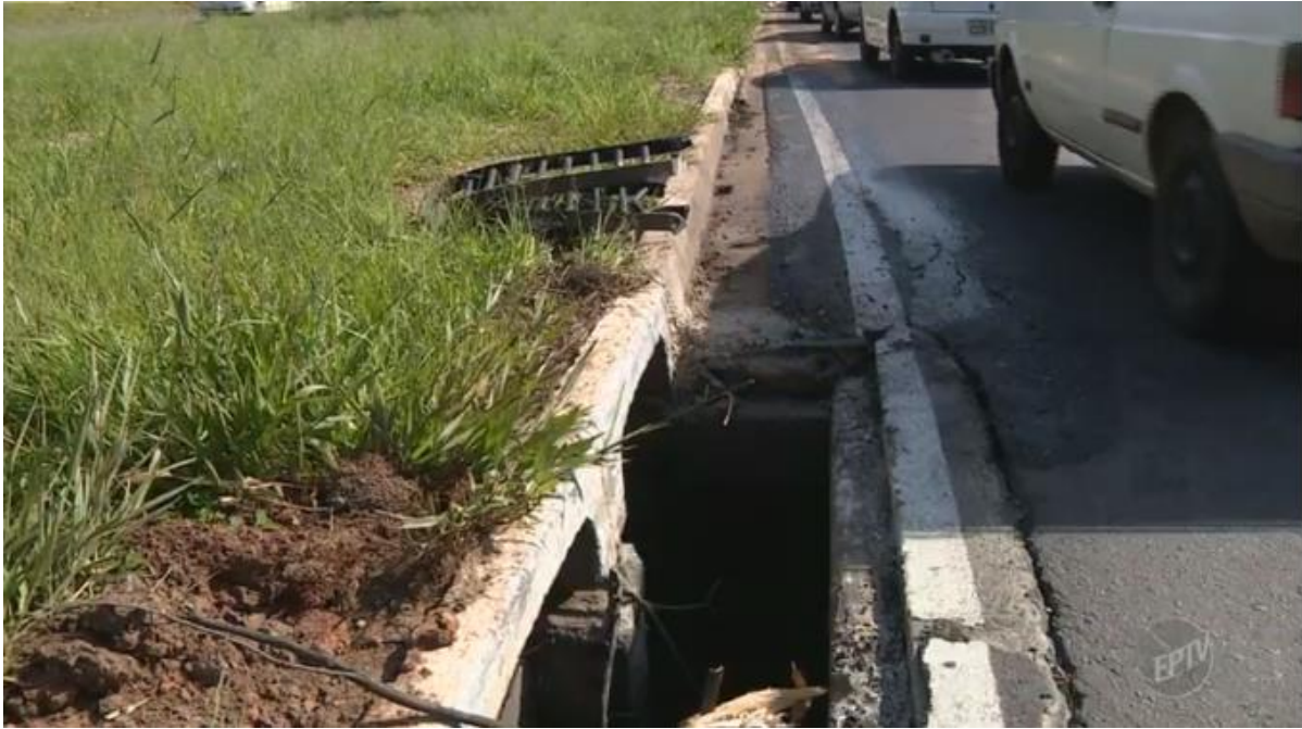
Figura 7 – Acidente ocorrido na Av. John Boyd Dunlop (Fonte: EPTV)
