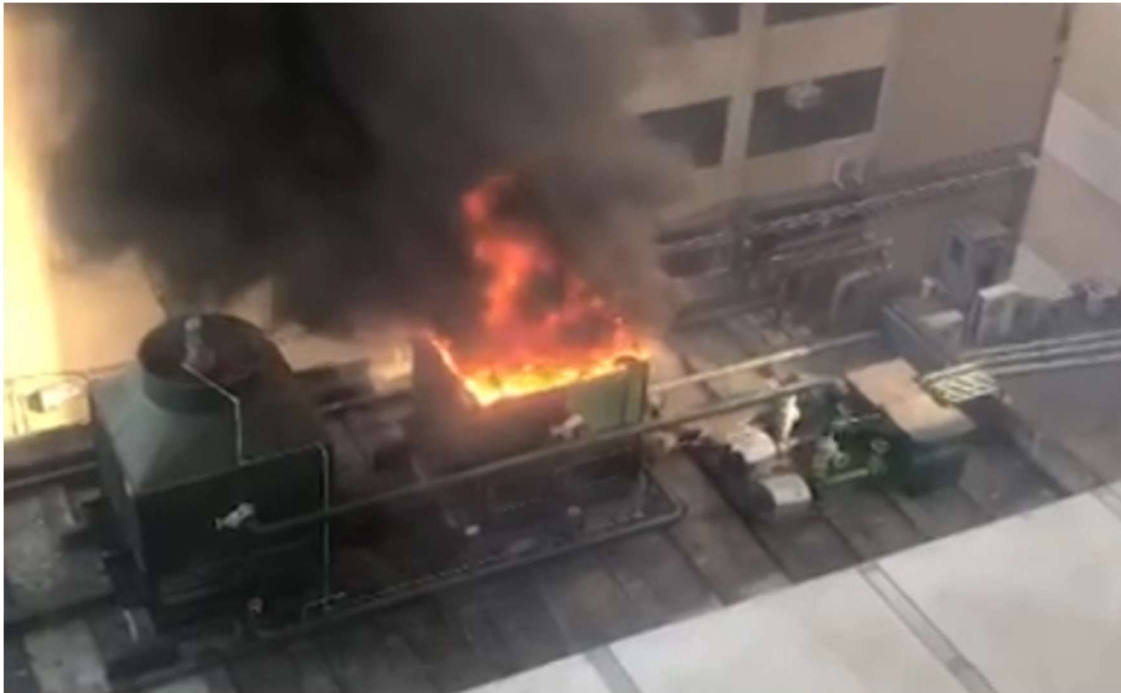
Figura 2 – Incêndio em torre de resfriamento
