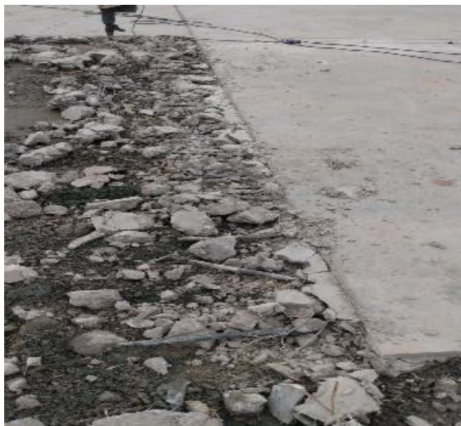
Figura 8 – Foto de evidência das barras de transferência posicionada de forma paralela à junta serrada (corte), e não no eixo. Cotia, São Paulo (Fonte: Próprio autor).
