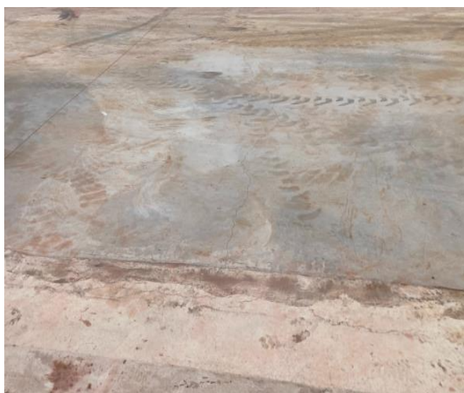
Figura 6 – Foto de trinca se abrindo devido a posicionamento irregular como mostrado na foto anterior. Cotia, São Paulo (Fonte: Próprio autor).
