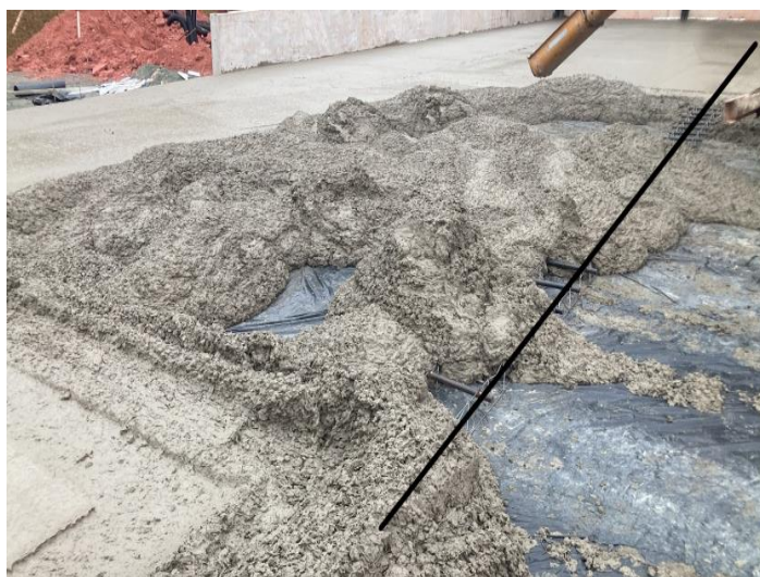
Figura 5 – Foto das barras de transferência desalinhada durante o lançamento do concreto. Obra Prologis logistics Real States - Cotia, São Paulo (Fonte: Próprio autor).
