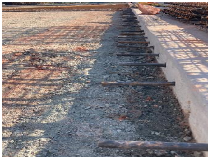
Figura 14 – Foto de evidência das barras de transferência posicionada de forma desnivelada, fora do eixo e com ângulo maior que 90° em relação a junta serrada (corte). Cotia, São Paulo (Fonte: Próprio autor).
