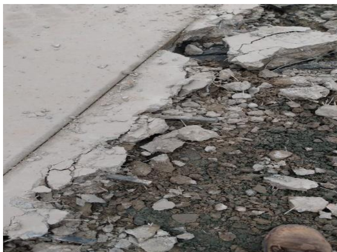
Figura 9 – Foto de evidência das barras de transferência posicionada além de forma descentralizada com maior que 90° em relação a junta serrada (corte). Cotia, São Paulo (Fonte: Próprio autor).
