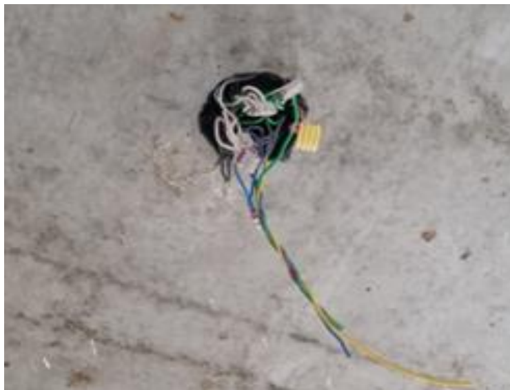
Figura 14 – Foto da caixa de passagem pequena e com diversos circuitos elétricos e fechamentos pré-existentes no empreendimento Altos da Avenida, Construtora Santa Angela, Jundiaí, São Paulo (23°13'05.3"S 46°52'05.4"W; -23.21815032689355, -46.86815393696144) (Fonte: Próprios autores).
