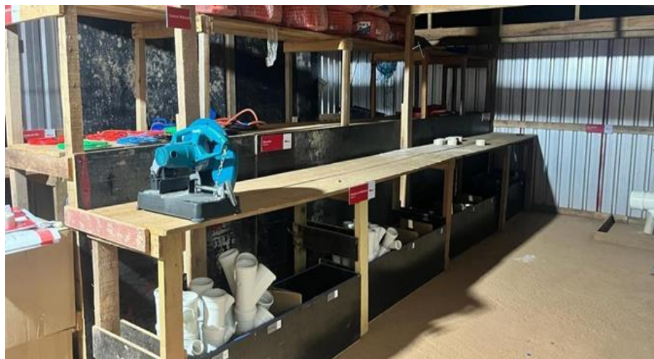
Figura 14 – Central de Kits hidráulicos (Fonte: Autores, 2023).
