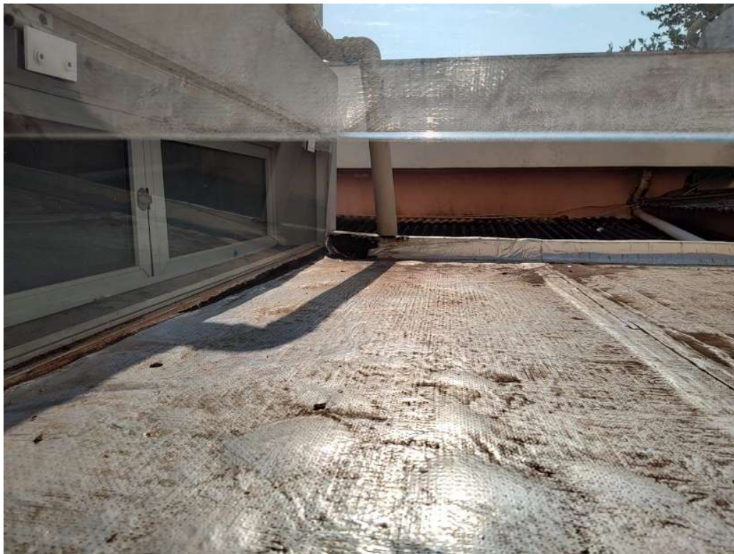
Figura 8 – Identificação de acúmulo de água sob a manta asfáltica existente.
