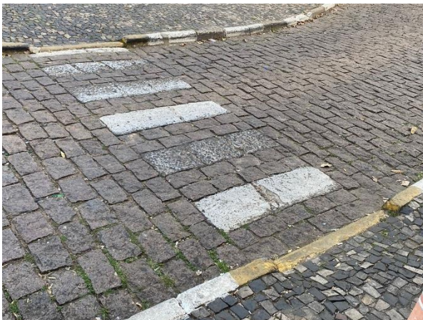
Figura 9: Falta de sinalização tátil de advertência nos rebaixamentos.
