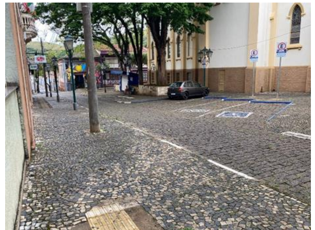
Figura 10: Interrupção da rota do piso tátil.
