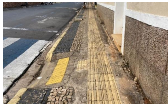
Figura 17: Rampa invade a faixa de circulação de pedestres.
