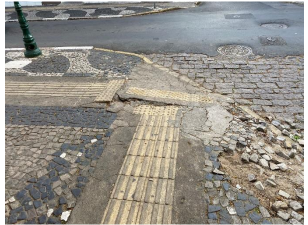
Figura 8: Rebaixamento que está sem manutenção.
