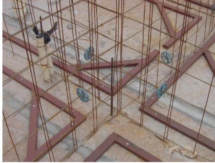
Figura 12: Fixação dos gabaritos e posicionamento para o travamento do "pé" da fôrma
