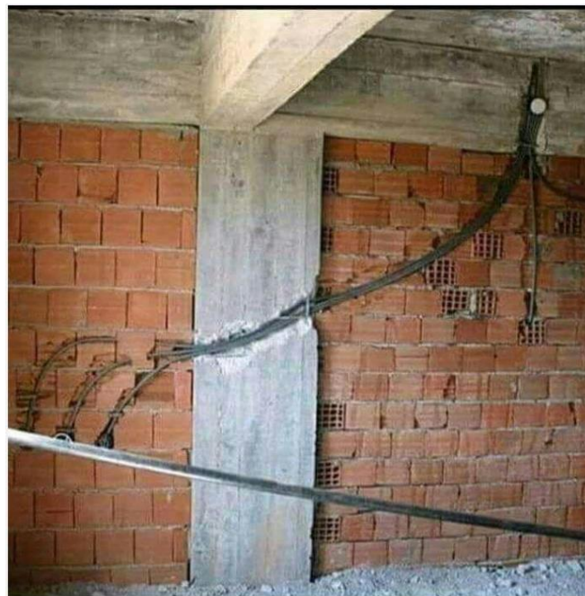
Figura 02 - Incompatibilidade entre projetos elétricos e estruturais (Fonte: https://maisengenharia.altoqi.com.br/estrutural/consequencias-falta-compatibilizacao-em-projetos/ )
