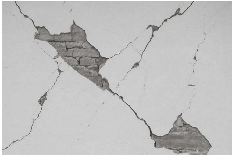
Figura 01 – Manifestação patológica (fissuração) em uma parede de alvenaria (Fonte: WEIMER, Bianca F.; THOMAS, Maurício; DRESCH, Fernanda. Patologia das estruturas, p-15)
