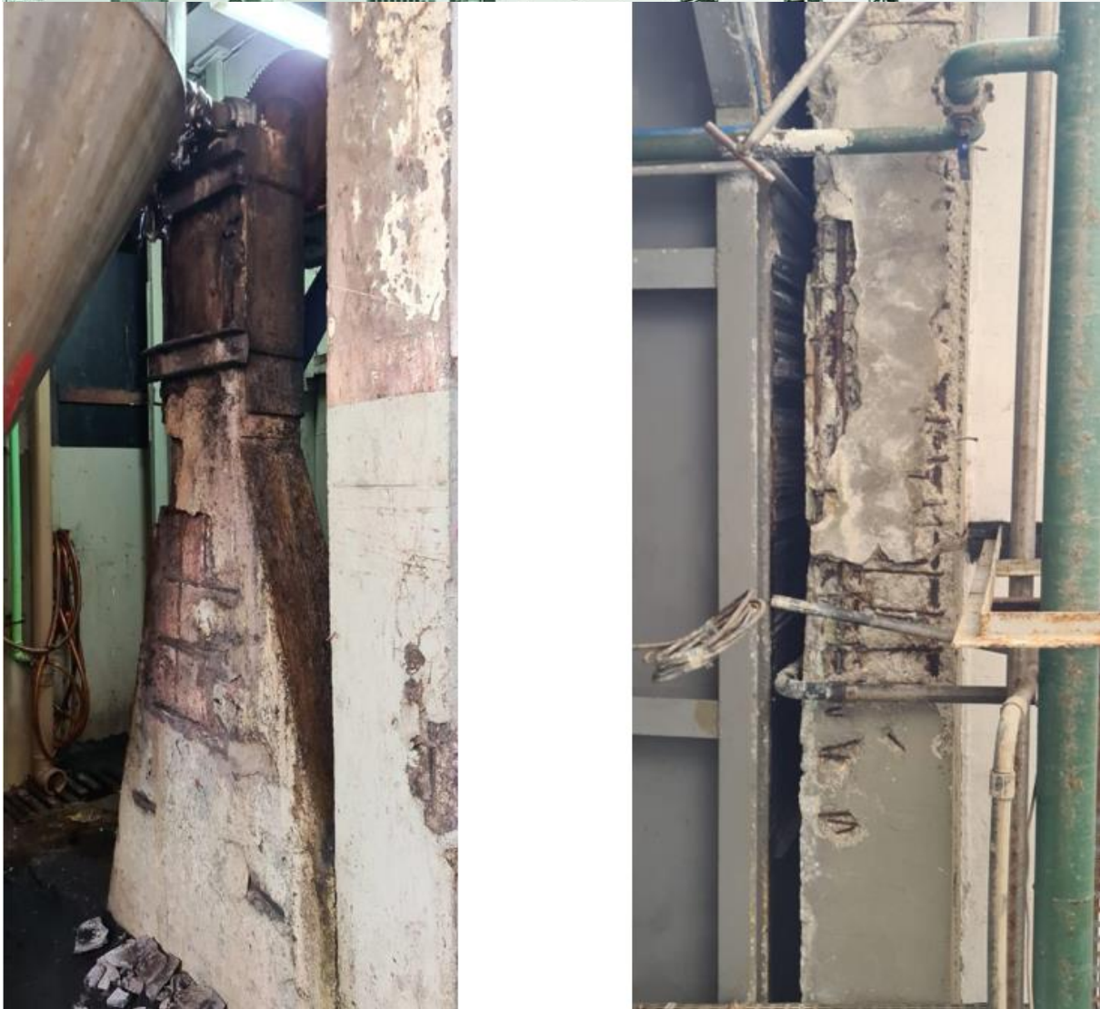
Figura 8 e 9 – Pilares com armadura exposta e sofrendo processo de corrosão. Fonte: Autoral.
