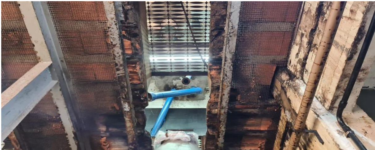
Figura 6 – Viga metálica com processo de corrosão. Fonte: Autoral.
