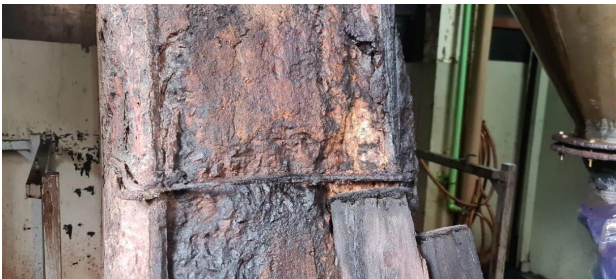
Figura 10 – Pilar com armadura exposta e com alto processo de corrosão da armadura. Fonte: Autoral.
