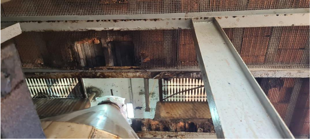
Figura 4 – Estrutura metálica sofrendo processo corrosivo. Fonte: Autoral.
