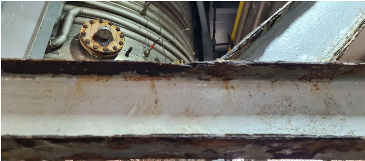
Figura 7 – Viga metálica com processo de corrosão. Fonte: Autoral.
