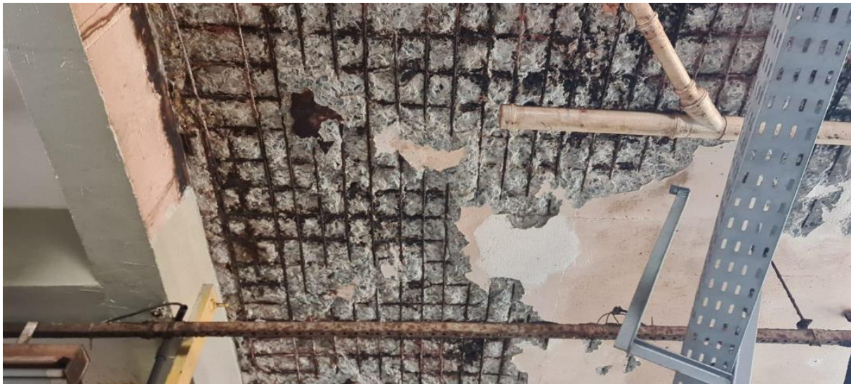
Figura 11 – Laje com armadura exposta e sofrendo processo de corrosão. Fonte: Autoral.
