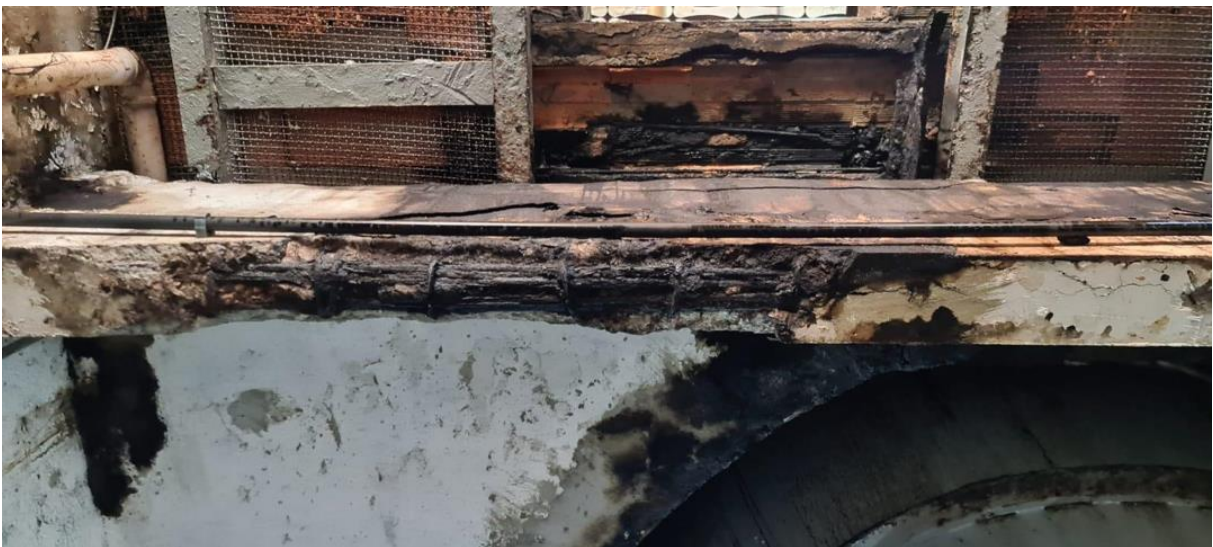
Figura 5 – Viga de concreto armado com armadura exposta sofrendo processo corrosivo. Fonte: Autoral.
