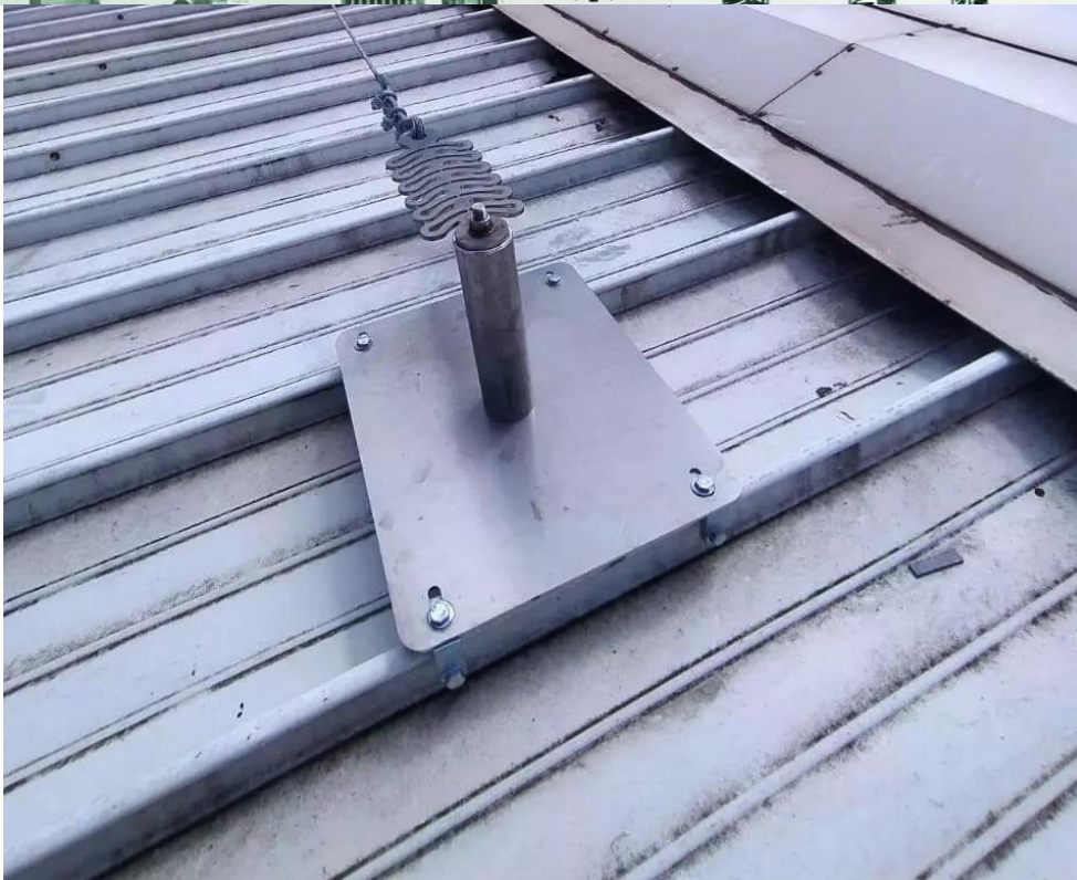
Figura 13 – Linha de vida instalada sobre as telhas zipadas com detalhamento da cumeeira e sistema de rufo. Itatiba, São Paulo (Fonte: Soler).
