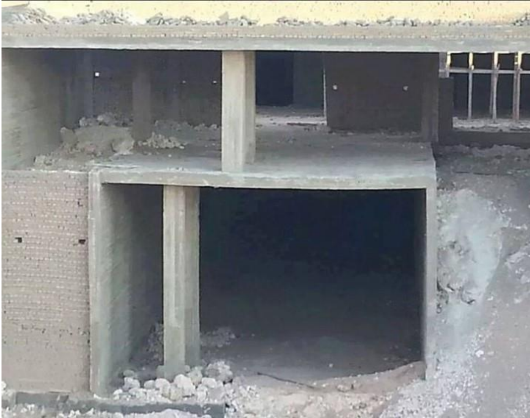
Figura 8: Pilar executado estruturalmente incorreto
