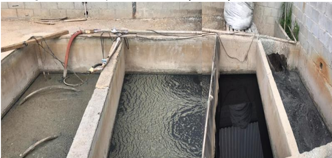
Figura 3 – Foto da estação de tratamento da empresa Primeplas, Itatiba, São Paulo.
