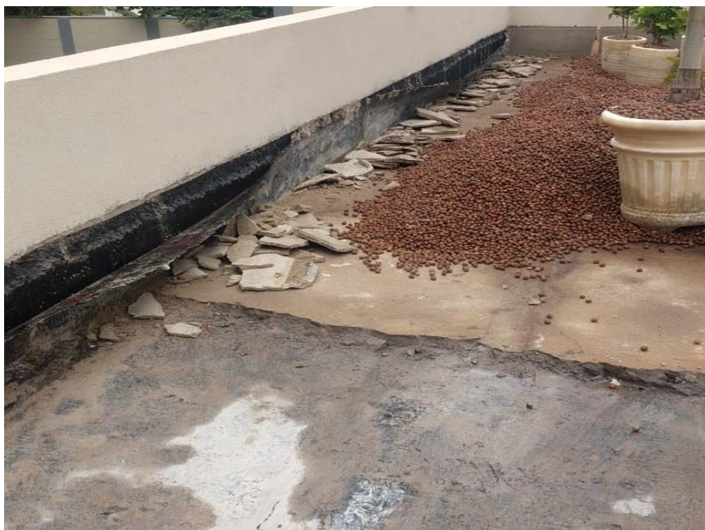
Figura 7: Má aderência da manta asfáltica Fonte: Autoria própria, 2020
