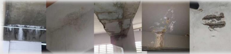
Manchas/Mofo/Bolor/Eflorescência/Corrosão da armadura
