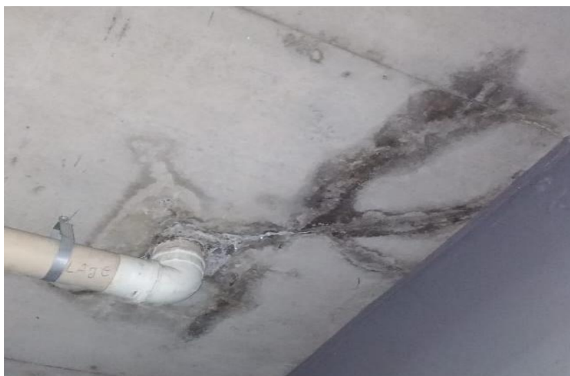
Figura 5: Mancha de umidade Fonte: Autoria própria, 2020
