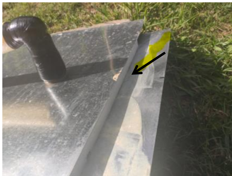
Figura 19 - Vazamento 1 (Fonte: Autor).
