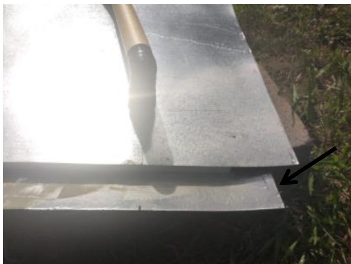
Figura 20 - Vazamento 2 (Fonte: Autor).
